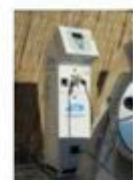
EV充電スタンド
